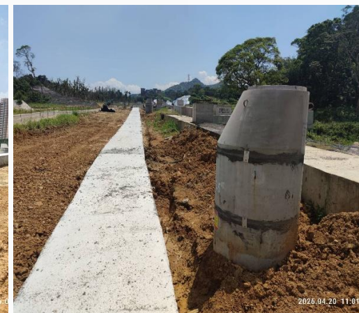
161kV管路 及污水人孔
